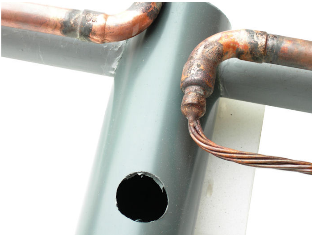
Fig.55: Primer plano del cable de conexión del condensador, soldado a una pieza de reducción de cobre en los extremos del bucle
