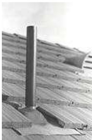
Fot. 9.16.1. „Ventenna” na dachu domu
