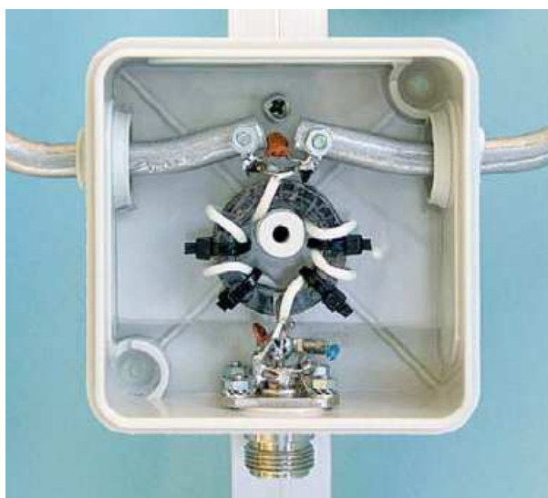
Fot. 9.21.3. Skrzynka przyłączeniowa z transformatorem 4:1
